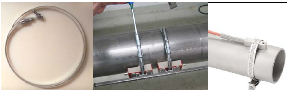
Abbildung 10 Befestigung der Ultraschallwandler und PT100-Sensoren mit Metallbändern auf der Rohrleitung
